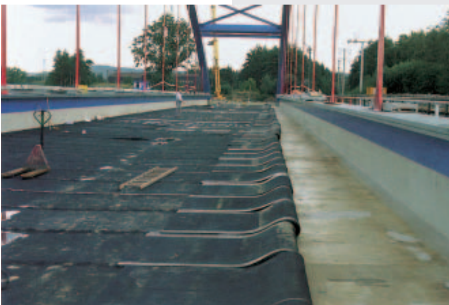
Clouth-USM® på en stålbro (Nürnberg)
